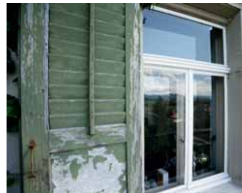
Optisch haben die Fensterläden Sanierungsbedarf, von der Dichtheit her die Fenster selber.
